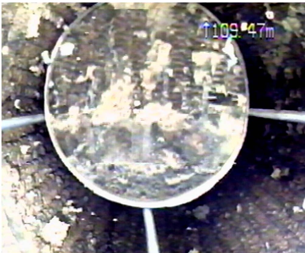
Foto 49: Filtros totalmente obturados por precipitados de carbonato de calcio.
