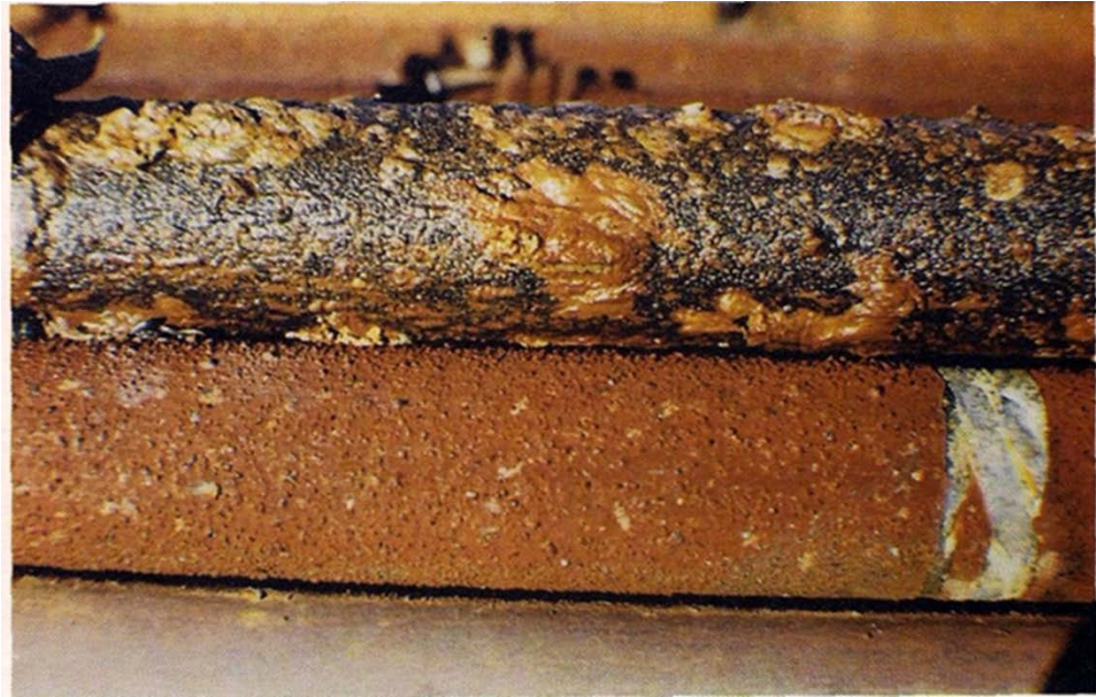
Foto 53: Actividad bacteriana en cañería de impulsión de electrobomba.
