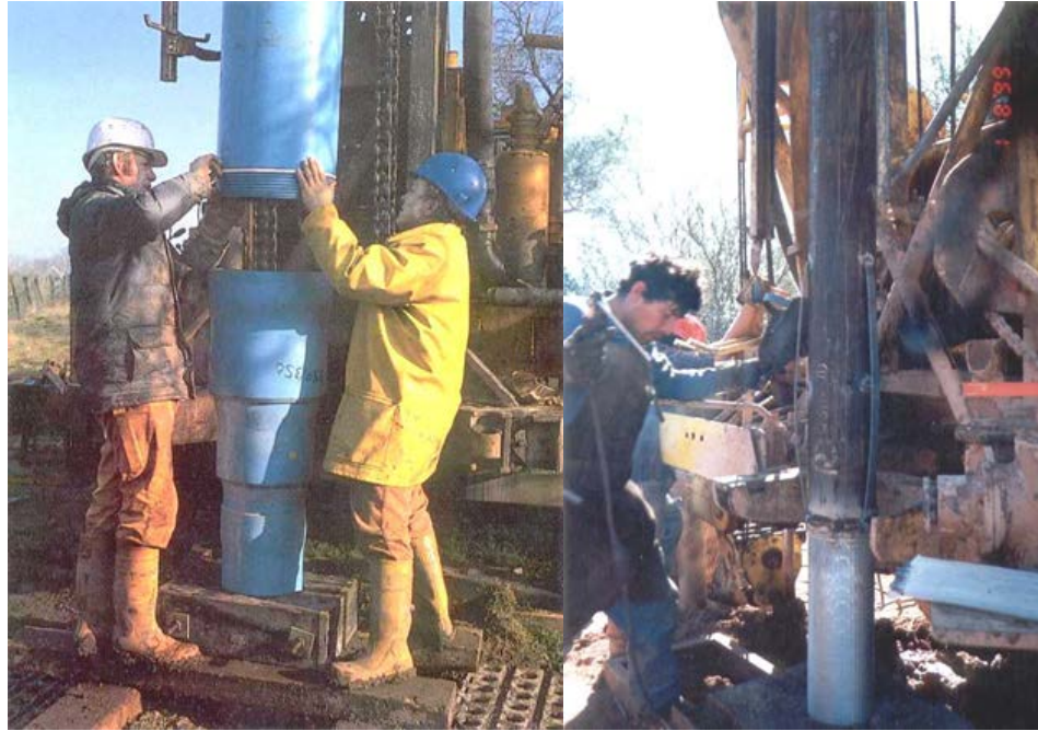
Foto 39: A la izquierda se observa una entubación con cañería de PVC, mediante roscas. A la derecha, columna de entubación (filtros y caño ciegos) en acero con conexión entre ambos tramos con soldadura eléctrica.
