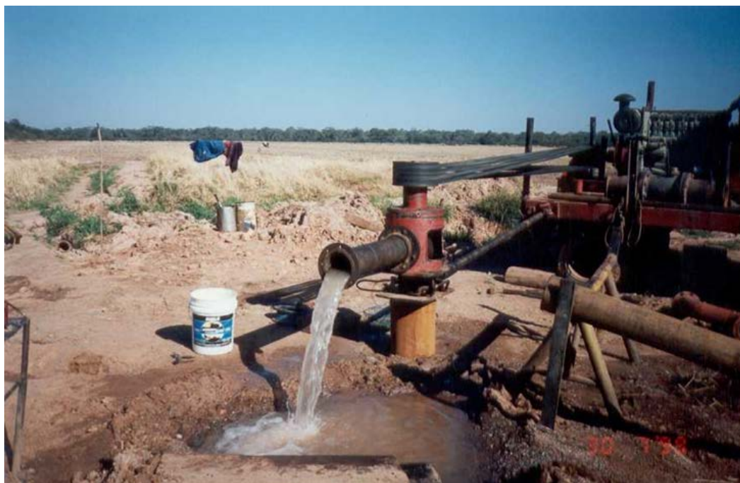
Foto 46: Bomba de eje. Se observa cabezal sobre el pozo y correas de distribución accionada por motor cardánico (atrás).
