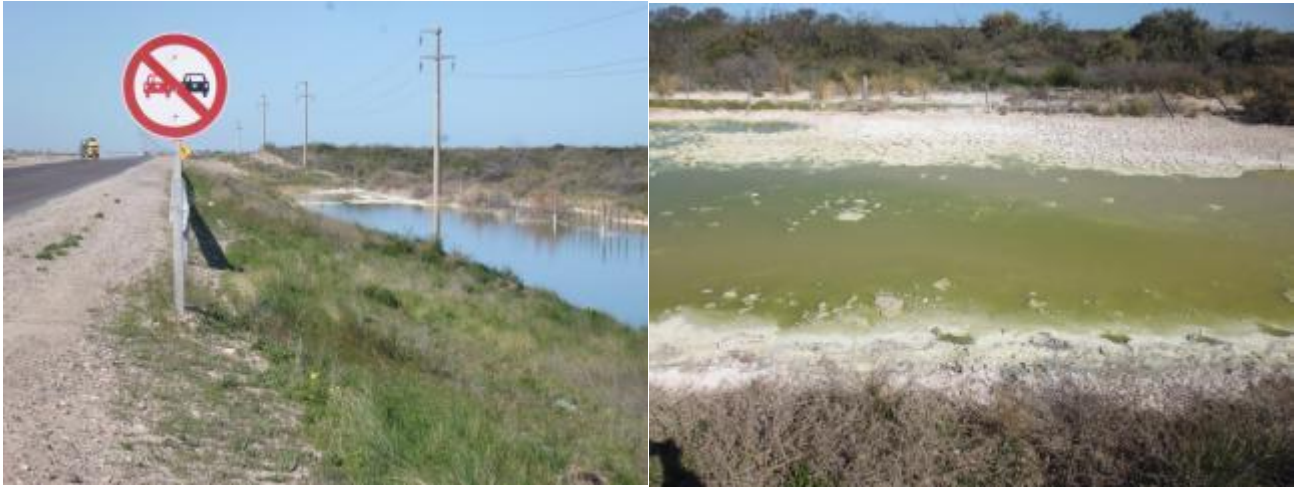
Foto 5. Acumulación del efluente de la Planta de Tratamiento sobre banquina de ruta nacional N° 3. En la foto de la izquierda se puede observar claramente el alto topográfico que impide que el líquido siga escurriendo en el sentido de la pendiente actuando como un dique de contención.
