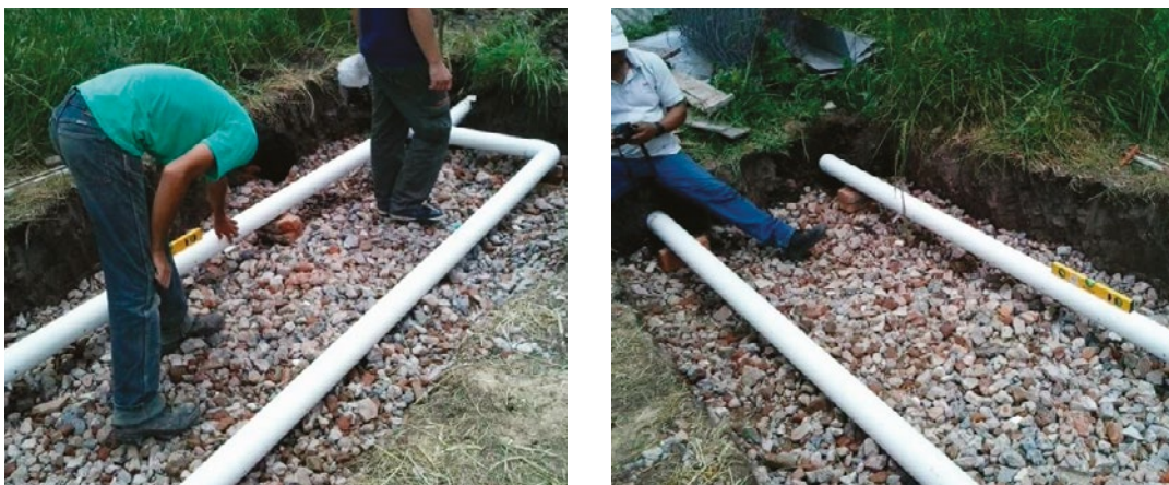
Imágenes 22 y 23. Lecho de infiltración.
